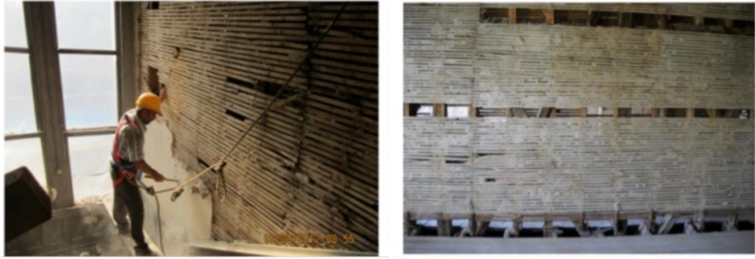
Görsel 88. Yenileme çalışması öncesi iç duvarlar bağdadi görselleri (Aralık 2013 Restorasyon Raporu).
