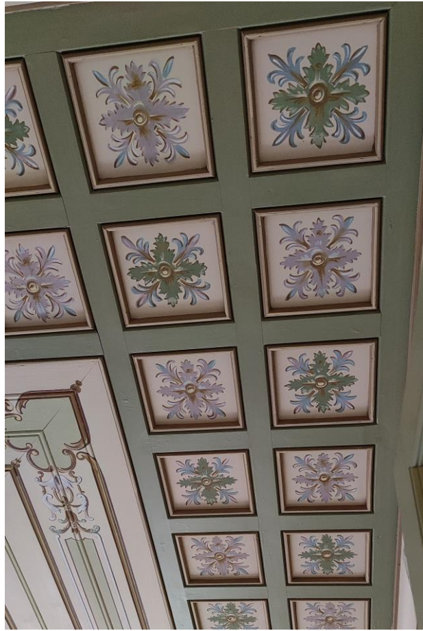
Görsel 131. Üçüncü kat Sofanın Umut Sokak (Sol) tarafında kalan odanın tavanda uygulanan kalem işi işleminin görseli (Fotoğraf: Sadık Çağrı Bildiş, 2022).
