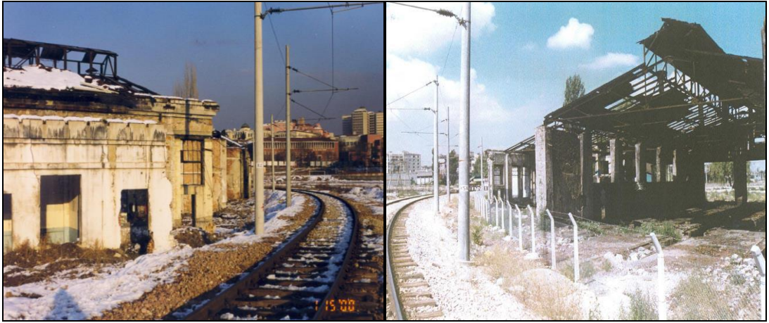
Resim 28,29. Cer Atölyeleri Yıkılan Bölümler (Kaynak: Uygur Mimarlık, Şubat 2000)
