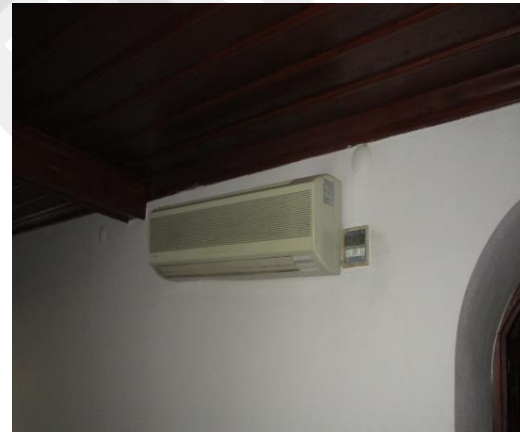
Resim 62. Adana Kültür ve Sanat Merkezi, Bodrum Kat Duvar Tipi Klima (Fotoğraf: Şükriye Sıla Özdemir, 2020)
