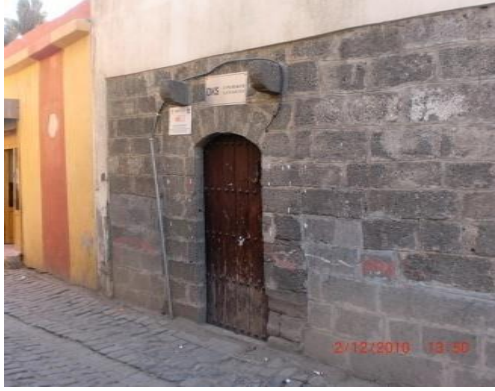
Resim 2 Onarımdan önceki giriş kapısı 74
