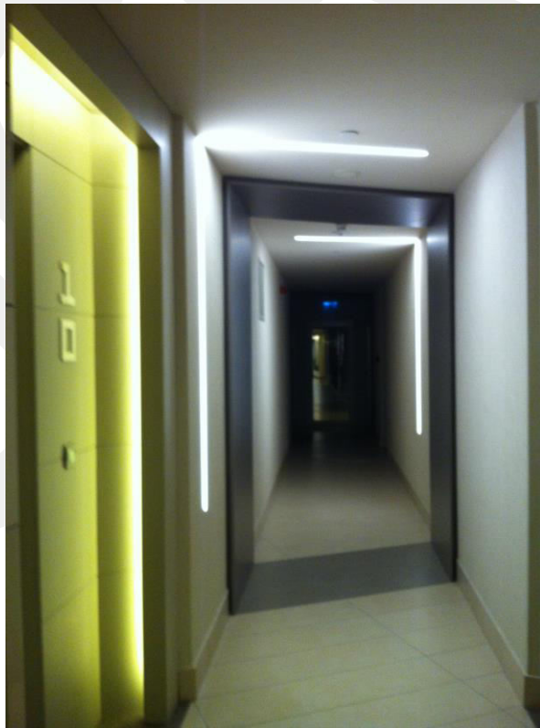
Şekil 76. Akasya AVM ve Rezidans, Yatay Blok Özel Tasarım LED Aydınlatma Elemanı (Fotoğraf: Pelin Barış, 31 Mayıs 2014)
